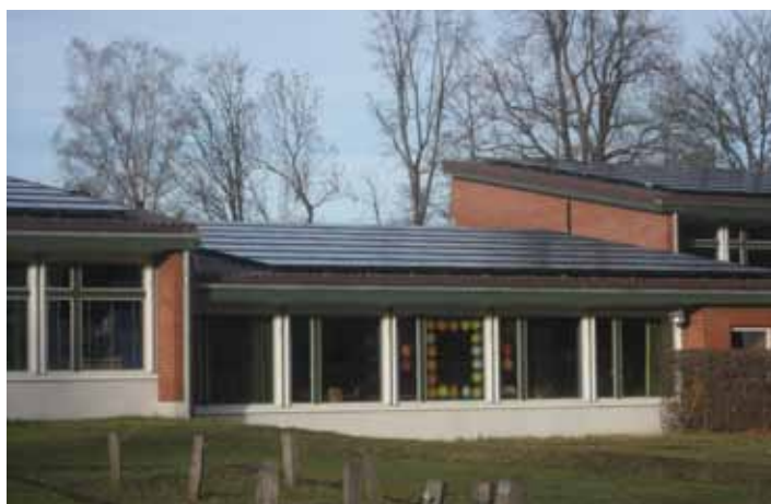
Photovoltaikanlage Primarschule Grossacker
